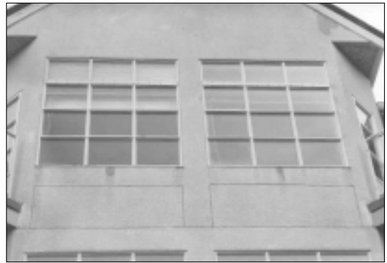
Figure 2. Exemple d'humidification localisée, conséquence d'une mauvaise étanchéité de fenêtre
