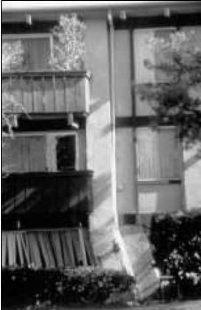
Figure 2. Déformation excessive d'un premier étage faible dans un immeuble d'appartements, tremblement de terre de Northridge, 1994. Dans une autre partie du bâtiment, le rez-de-chaussée s'est complètement effondré.
